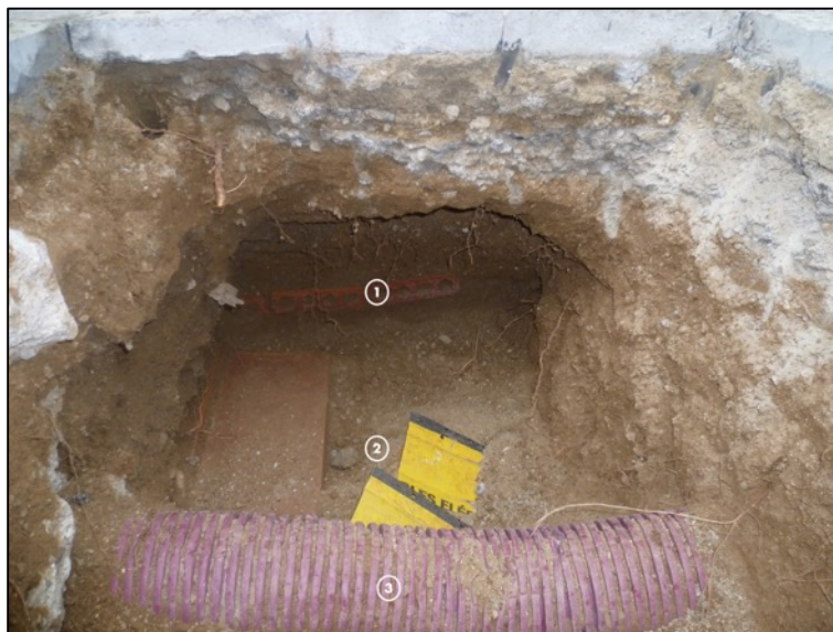
Fotografia 40. Vista detall diversos serveis localitzats a la vorera. 1.Electricitat; 2.Electricitat; 3.Tub corrugat morat.
