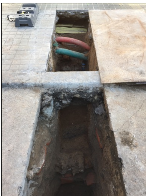
Fotografia 4. Vista general serveis localitzats a la Cala 1 concentrats a la zona de la vorera.
