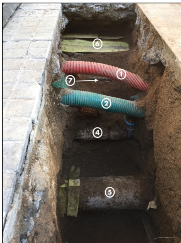
Fotografia 5. Vista en secció dels diversos serveis localitzats. 1.Electricitat (senyals trànsit); 2.Tub corrugat indeterminat; 4.Aigua; 5.Gas; 6. Electricitat; 7.Electricitat.
