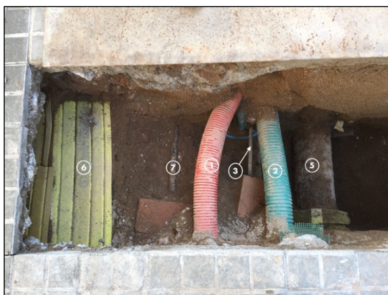
Fotografia 6. Vista en planta dels diversos serveis localitzats. 1.Electricitat (senyals trànsit); 2.Tub corrugat indeterminat; 3.Electricitat (enllumenat públic); 5.Gas; 6.Electricitat; 7.Electricitat.
