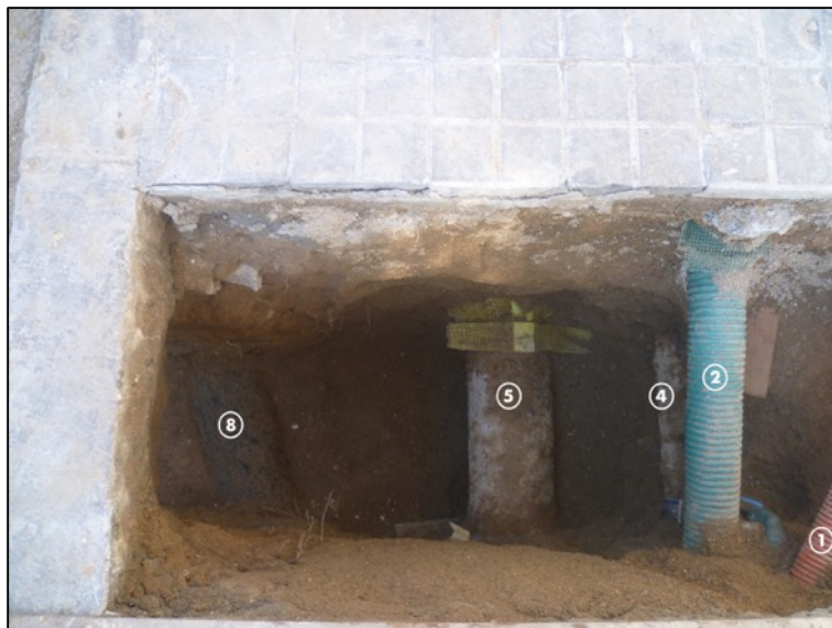
Fotografia 7. Vista en planta dels diversos serveis localitzats. 1.Electricitat (senyals trànsit); 2.Tub corrugat indeterminat; 4.Aigua; 5.Gas; 8.Indeterminat.
