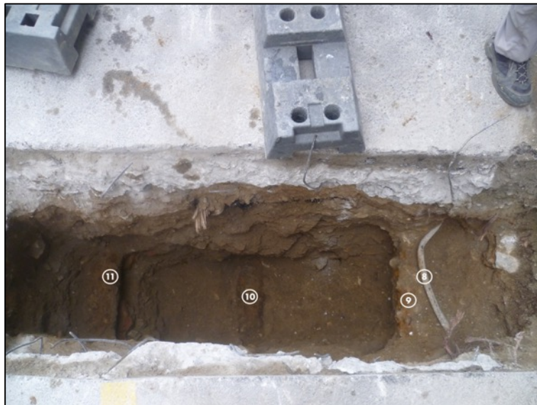
Fotografia 75 . Vista general serveis localitzats a la calçada. 8.Electricitat; 9.Tub metàl·lic indeterminat; 10.Tub metàl·lic indeterminat; 11.Tub metàl·lic indeterminat.
