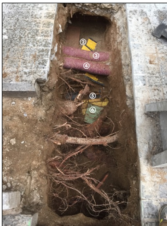
Fotografia 37. Vista general serveis localitzats a la vorera. 2.Electricitat; 3.Tub corrugat morat; 4.Tub corrugat morat; 5.Aigua; 6.Electricitat.
