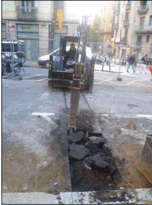
Fotografia 11. Picat de l'asfalt de la calçada UE103.
