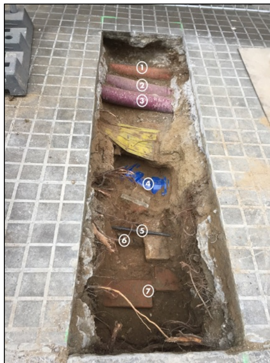
Fotografia 72. Vista general serveis localitzats a la vorera. 1.Electricitat (senyals trànsit); 2.Tub corrugat morat; 3.Tub corrugat morat; 4.Aigua; 5.Electricitat (enllumenat públic); 6.Electricitat; 7.Electricitat.
